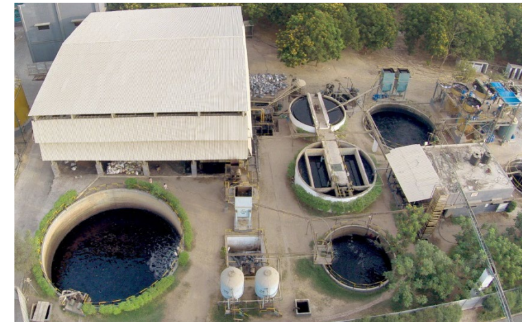
Effluent Treatment Plant (ETP)
